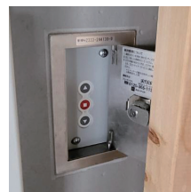
シャッター開閉ボタン
