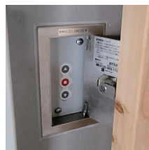
シャッター開閉ボタン
